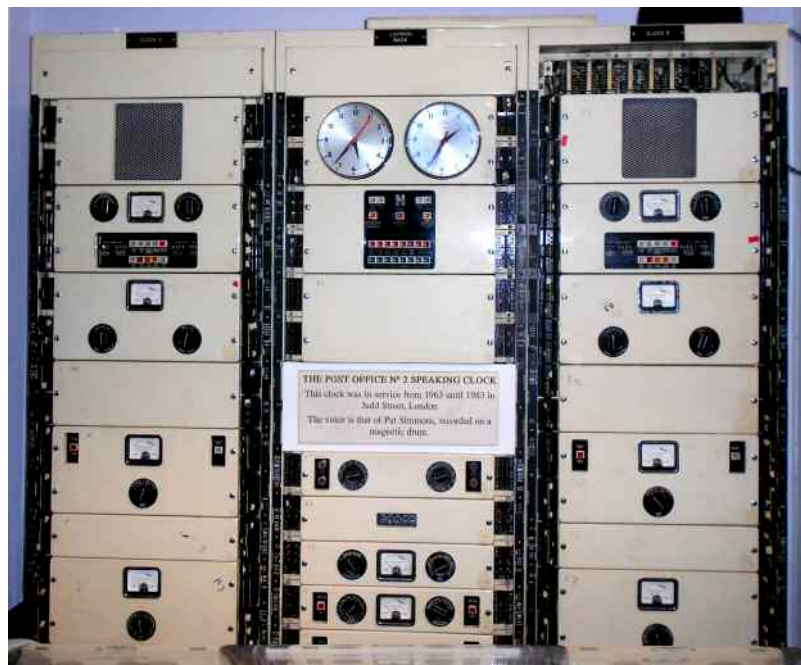
Fig. 10 - Gli armadi contenenti l'orologio e l'elettronica di sincronizzazione dell'orologio parlante N. 2 del Post Office britannico (Immagine cortesemente concessa dal British Horological Institute).
